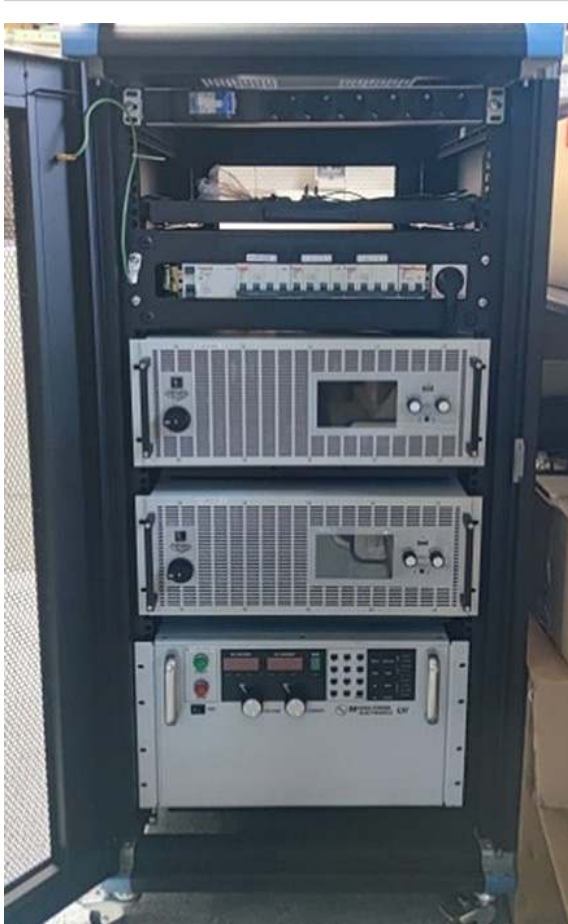
Figura 6. Rack de fuentes bidireccionales del laboratorio de la unidad de Accionamientos Eléctricos del CIEMAT.
